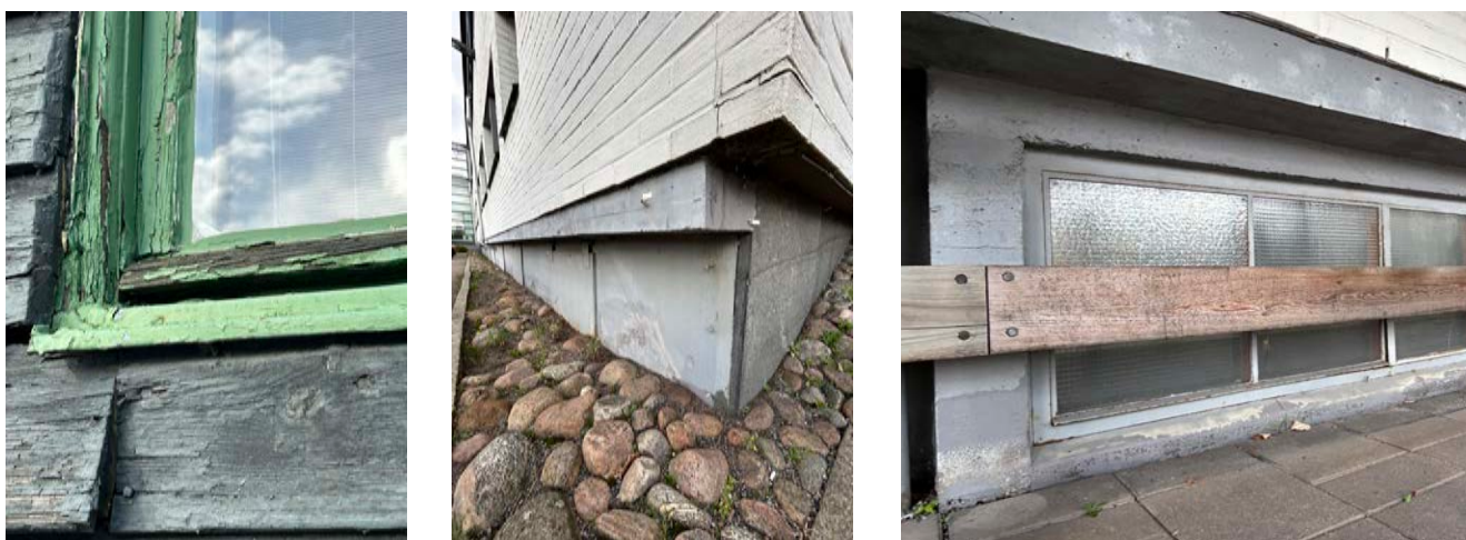
Till vänster ser vi exempel på en fönsterkonstruktion med inbyggd droppnäs i bågen. En äldre lösning som fungerar om fönstren är av god träkvalitet. En modernare lösning är en dropplist av plåt, men då det bildas kondens under plåten riskerar den snarare att utgöra en punkt med risk för rötskador på bågen. Telegrafbyggnadens lagerlokals fönster är i stort behov av renovering. I första hand skrapning, ommålning och kittning, men troligtvis även trälagningar av bågbottenstycke och nederdel av karm. I mitten ser vi exempel på den tilläggsisolering som skett på flertalet fasader vända mot Byfogdegatan och mot gården. Ett rött tegel har använts vid tilläggsisoleringen, som i senare skede troligtvis har målats vitt. Fotot till höger visar de gamla källarfönstren som har täckts för med en plank då cykelparkering erbjuds där. Även här blir det tydligt att fasaden är kraftigt tilläggsisolerad. Foto: Ulrika Lindh
