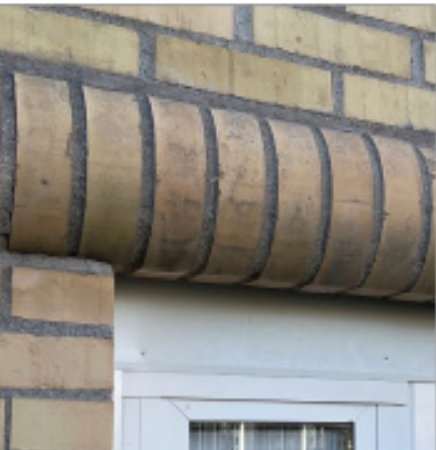
Foto 41: Tegelbalken i närbild.
