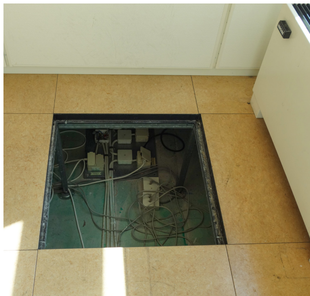
Foto 22: Installationsgolv för flexibilitet.
