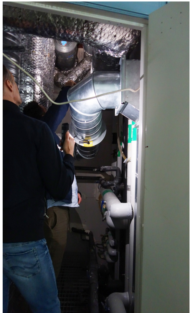
Foto 58: Teknikutrymme i byggnaderna
