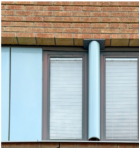
Befintlig murad fasad och fönsterband med ljusa cyanblå kassetter av emaljerad stålplåt
