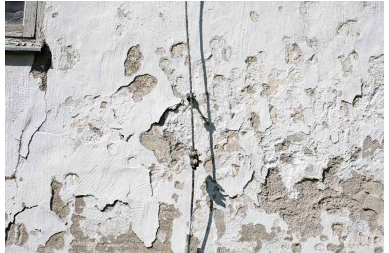
Skadad puts på ladugårdsvägg, maj 2023.
