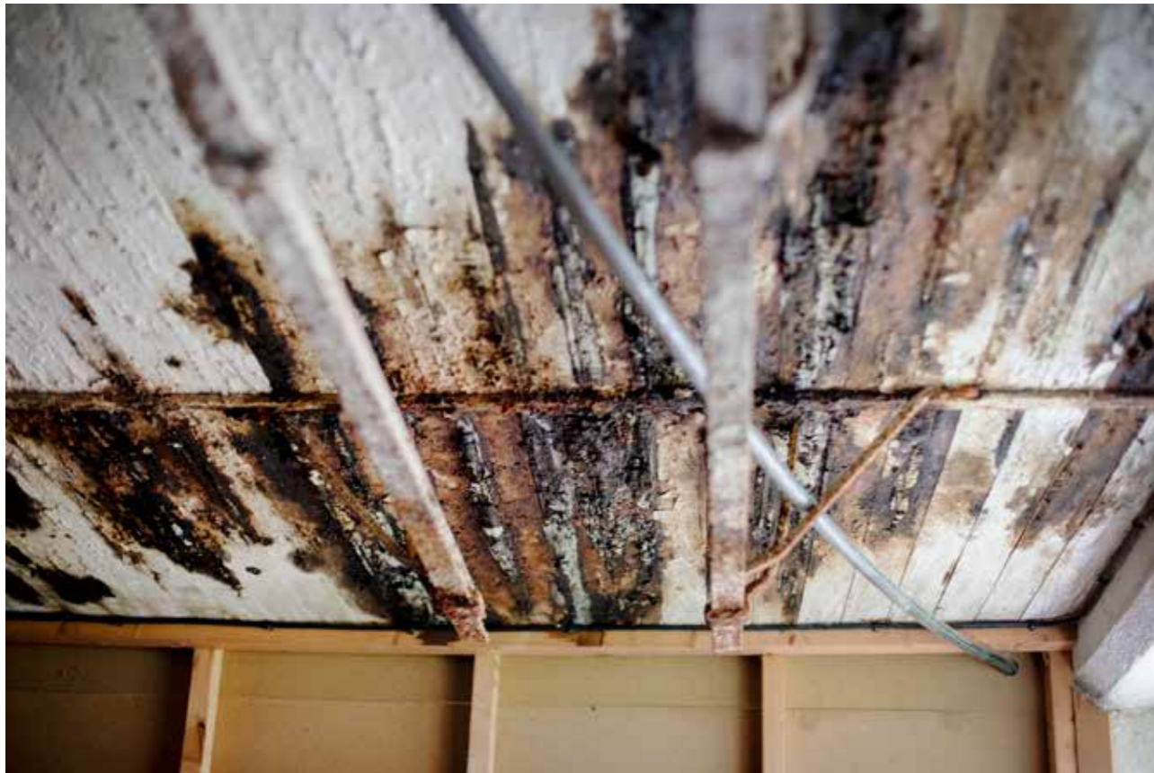
Fuktskada i ladugårdens norra del, oktober 2023.
